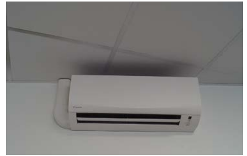
Climatisation salle polyvalente
